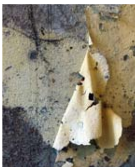
OM FÄRGEN SLÄPPER på källarväggen, är det ett säkert tecken på att fukt har trängt in. Då kan du behöva åtgärda husets dränering.
