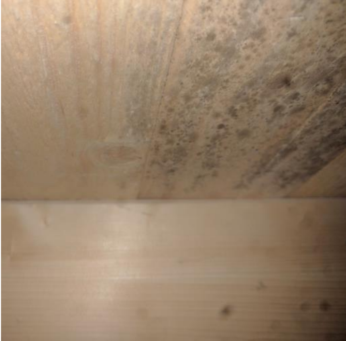
Bild 17. Avsaknad av ångspärr runt ventilationskanalen i föregående bild gör att inomhusluft leds upp på vinden där den kyls ner och orsakar mikrobiella skador/ mögel på underlagstakets råspont.
