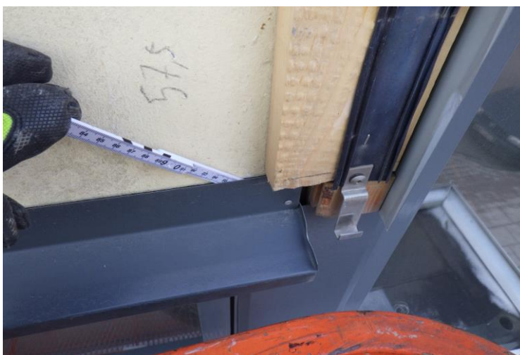
Bild 14. Ett vattenutledande bleck som monterats på utsidan av vindskyddskivan istället för på insidan av denna. Detta gör att vatten som rinner på vindskivan inte leds ut ur konstruktionen utan istället tränger in i springan mellan vindskyddskivan och bleckets uppvik (se tumstocken) och sedan tar sig in i konstruktionen där det orsakar skador.
