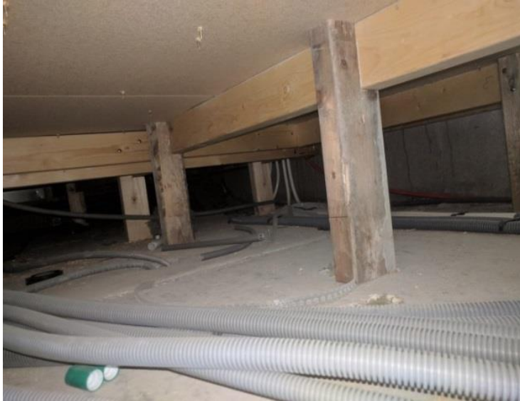
Foto 13. Ett uppreglat golv där man i brist på annat material använt regler från fuktskadade skyddsräcken.
