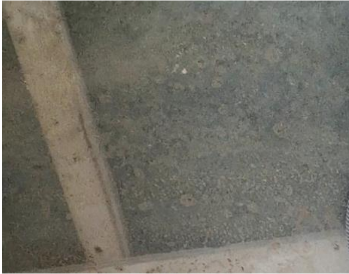
Foto 9. Undersidan på ett golvbjälklag som blivit nedsmutsat under transport.
