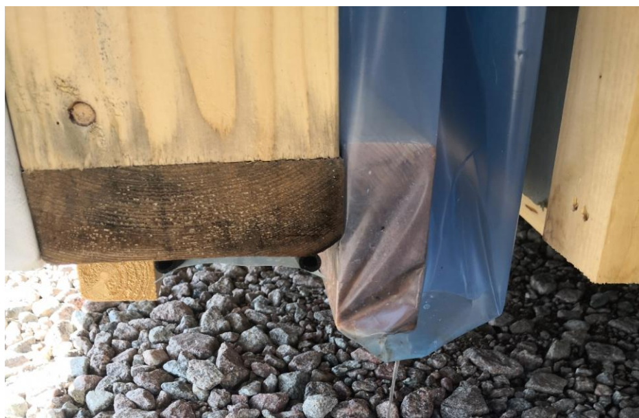
Foto 12. Felaktig mellanlagring av prefabricerade ytterväggar där regnvatten läckt in väggarna och vattnet samlats upp i en ficka som viks upp av väggens ångspärr. Notera vattnet som rinner ut ur plasten i botten av vattenuppsamlingen efter det att hål gjorts i denna med en kniv.
