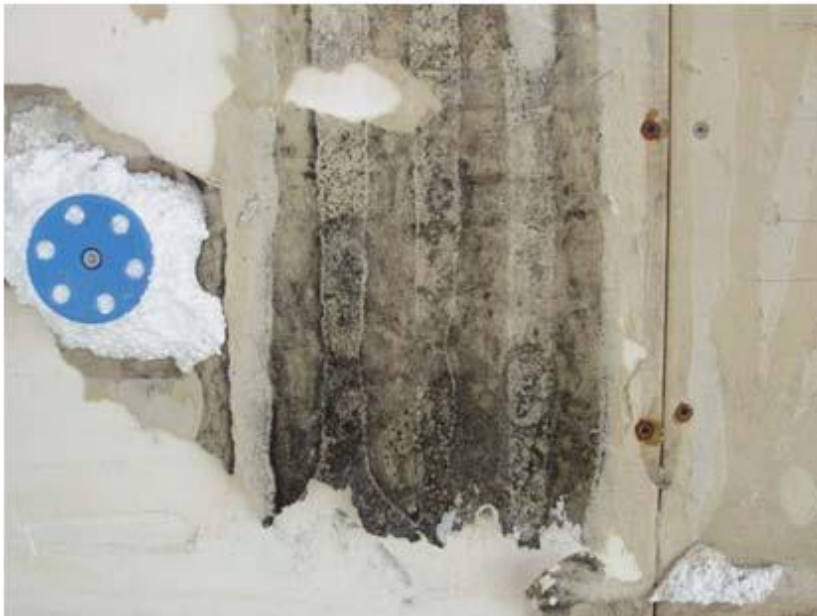
Foto 3. Mikrobiell påväxt/ mögel på utegipsskivan bakom en cellplastisolering i en enstegstätad fasad.
