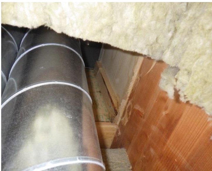
Bild 16. Ångspärr saknas runt genomföringar i taket där en ventilationskanal går upp till kallvinden
