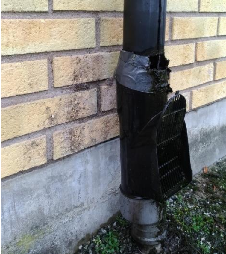
Bild 18. En trasig anslutning mellan stuprör och lövrens som lagats med tejp. Missfärgning på fasaden visar att anslutningen varit trasigt en längre tid innan det lagades med tejp.
