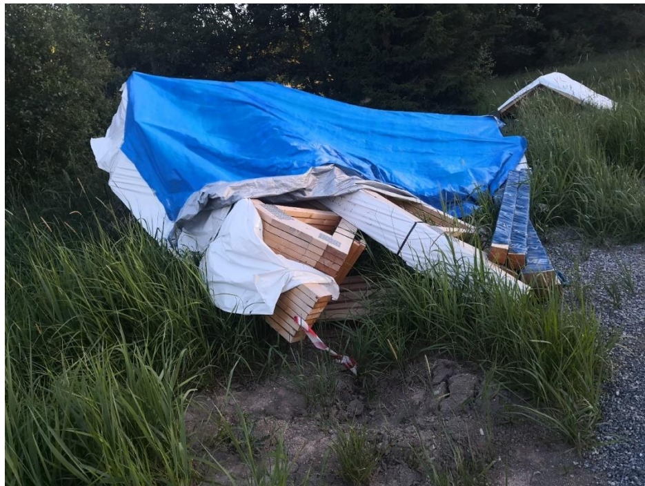
Foto 11. Takstolar som levererats före sommarsemestern men inte byggts in under tak och blivit liggande på byggarbetsplatsen hela semestern.
