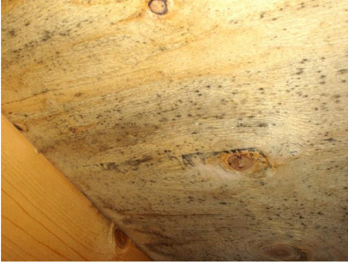
Foto 6. Synlig mikrobiell påväxt/ mögel på insidan av underlagstaket, även kallad råspont, på en kallvind pga att fuktig luft trängt upp i konstruktionen och orsakat skador.
