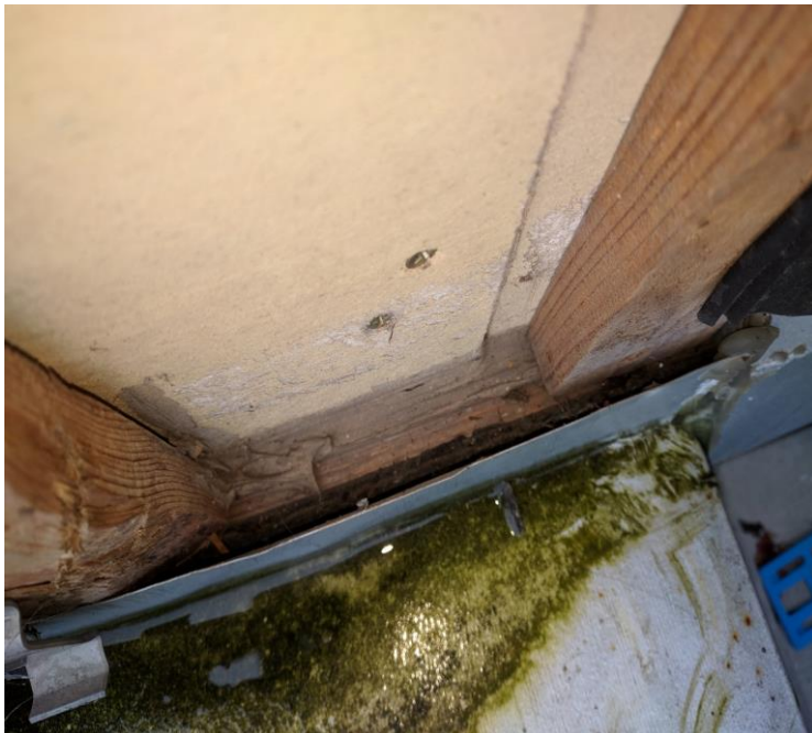
Bild 15. En vattenutledande plåt som monterats på ett sådant sätt att en balja skapats där regnvatten kan samlas upp och orsaka skador.
