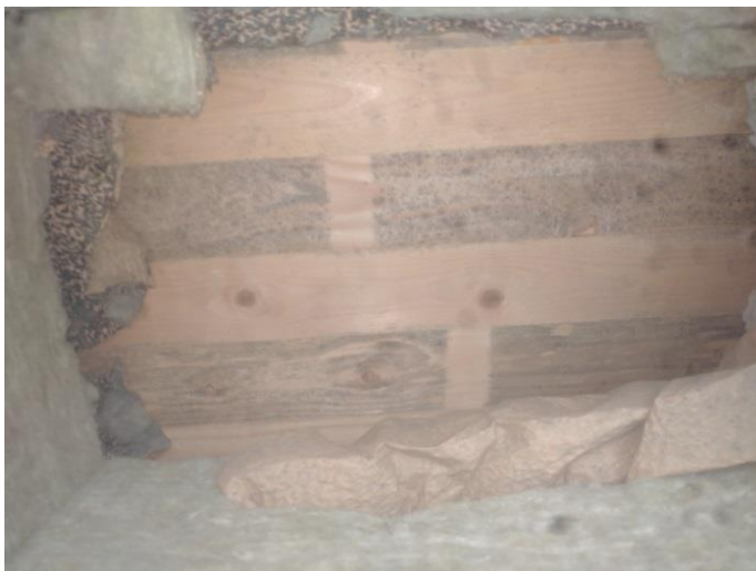
Foto 10. Mikrobiellt skadat/ mögelskadad råspont som byggts in. Strecken på råspontbrädorna visar var buntbanden suttit vilket i förläningen visar att materialet varit skadat redan innan inbyggnad.
