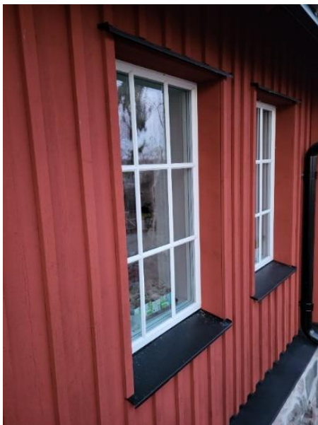
Bild 4. Ett bra exempel på fönster som placerats tillräckligt långt in i fasaden, väl innanför lutspalten, samt med vattenutledande bleck både ovanför och under fönstret.
