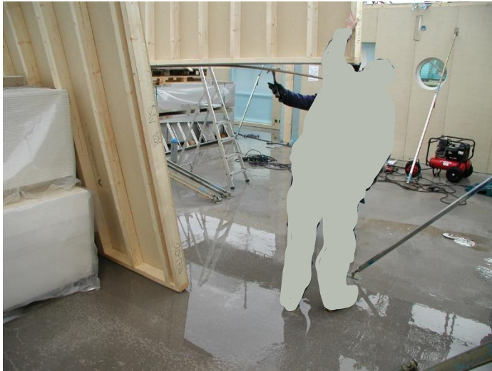
Foto 8. Husmontage i hållregn vilket gör att de prefabricerade byggelementen fuktas upp vilket i förlängningen sannolikt leder till skador.
