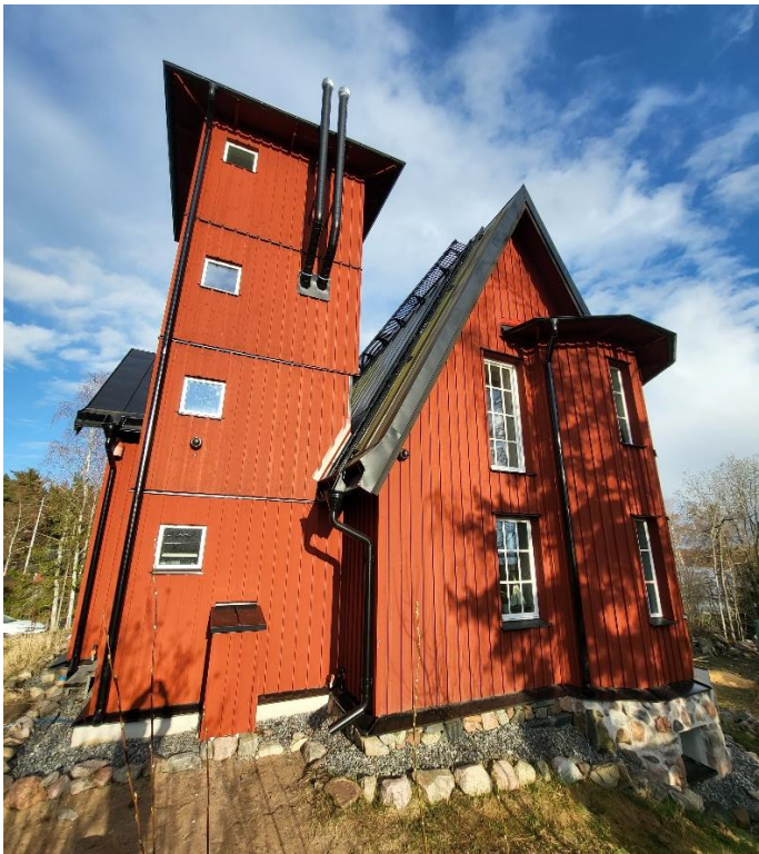
Bild 1. Takfall mot ett torn där en snöficka bildas mellan tak och tornets yttervägg som behöver skottas på vintern för att inte riskera att fuktskador uppstår.
