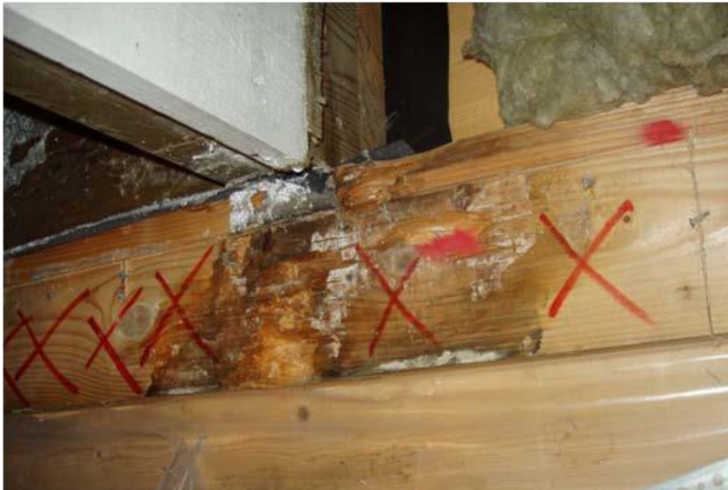
Foto 2. Regelstomme bakom en enstegstätad fasad där vatten trängt in i och fuktat upp samt skadat konstruktionen.
